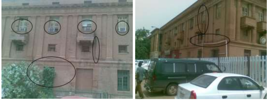
(شكل-5) مواسير الصرف الصحي ووحدات التكييف شوهدت المبنى-المصدر: الباحثة 2015
